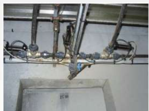
Canalisation de distribution en PVC pression Ø 25 et vannes de distribution à 3 voies commandées par vérin pneumatique.
