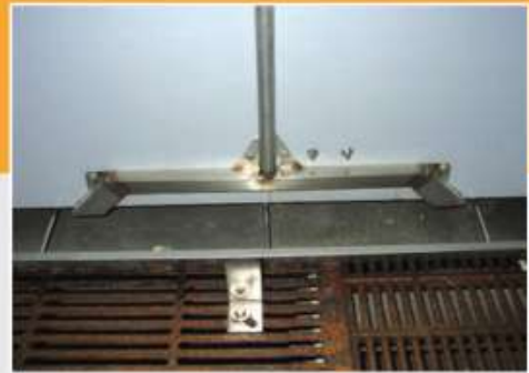
Descente en acier inox assurant une bonne répartition de la soupe dans l'auge, que ce soit lors de la poussée de la soupe par la pompe ou par l'air comprimé.
