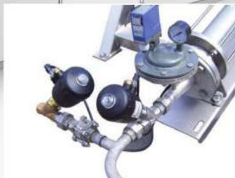
Pressostat de sécurité en sortie de pompe et vannes à piston à commande pneumatique : fermeture sortie de pompe, injection air comprimé et injection eau de rinçage.
